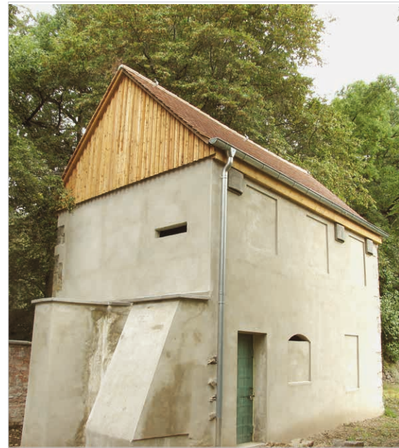
Als Quartier für die Kleine Hufeisennase ( Rhinolophus hipposideros ) optimiertes Gebäude mit vegetationsnahen Einflügen und einer fledermausgerechten Holzverkleidung für spaltenbewohnende Arten. (Foto: Thomas Frank)
