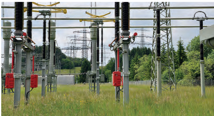
Glattthaferwiese an einem Umspannwerk. (Foto: Johann Schreiner)
