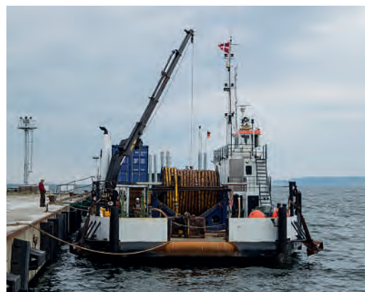
Unterwasserschallschutztechnik im Einsatz: Der „Große Blasen schleier“ wird für einen Einsatz vorbereitet. Der mit Löchern versehene Schlauch (in der Bildmitte auf einer Trommel aufgerollt) wird auf der Windparkbaustelle ringförmig ausgelegt, Druckluft aus Kompressoren entweicht in die Wassersäule und erzeugt einen Schleier aus schalldämpfenden Luftblasen. (Foto: Matthias Steitz)
