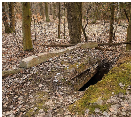
Auch ehemalige Bunker müssen im Rahmen der Verkehrssicherungspflicht gesichert werden. (Foto: Thomas Stephan)
